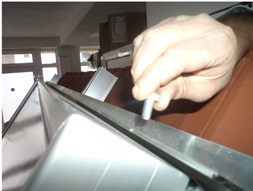
6-1. Solární kolektory jsou umístěny na profilech a upevněny šrouby (pohled shora)
